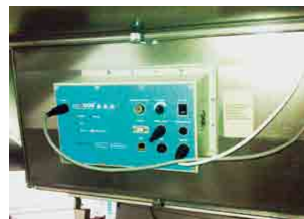
Ozongenerator am Luftkanal
